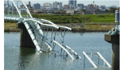
図1 六十谷水管橋崩落事故
